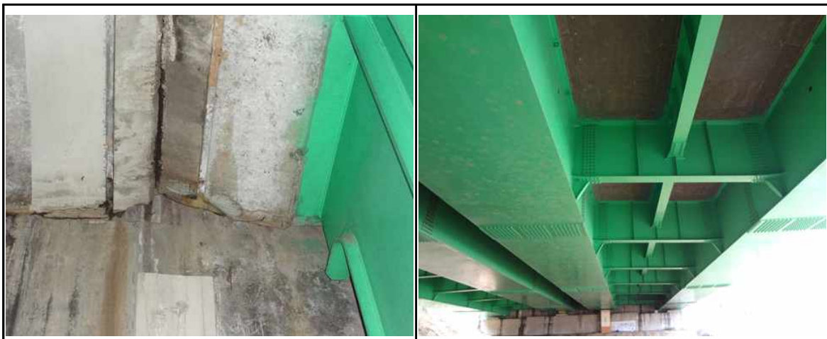
하행선 S1 콘크리트 손상
