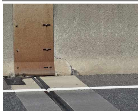
하행선 S1 중앙분리대 콘크리트 손상
